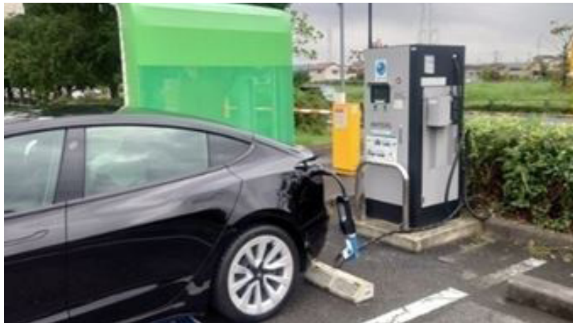
公共用充電器を設置した駐車場(都立公園の例)
