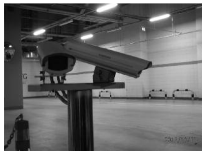
車両外観撮影カメラ
