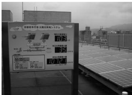
太陽光発電装置 (2号館屋上)
