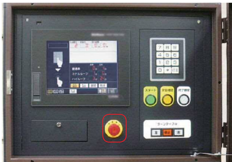
緊急停止ボタンの設置例
